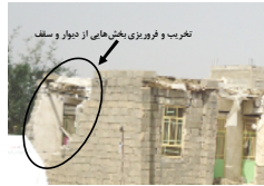
شکل ۸ - تخریب خارج از صفحه در دیوارهای یازیر و سقف ساختمانی ساخته شده با بلوک بتنی در شهر شنبه
