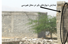
شکل ۷- نمود تخریب ساختمانی ساخته شده با بلوک بتنی در شهر شنه
