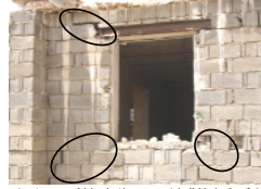
شکل ۴ - ترک‌های اطراف بازشوی پنجره ساختمانی با بلوک بنتی در شهر شنبه
