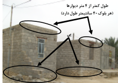
شکل ۱۱- ساختمان‌هایی در روستای کردلان که به‌دلیل برخورداری از ایجاد و بی نسبتاً مناسب طی زلزله آسیب ندهنده بودند.
