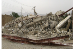
شکل ۱۰- فروری و تخریب کامل ساختمانی ساخته شده از بلوک بتنی در شهر شنبه
