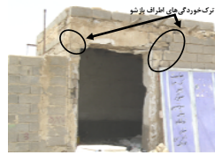
شکل ۳ - مود تخریب ساختمانی ساخته شده با بلوک بنتی در روستای درویشی
