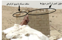
شکل ۱۲- عدم اسپیدیگی سرویس بهداشتی جنب امامزاده جمیلو واقع در نزدیک ترین فاصله تا تانکون سطحی زلزله
