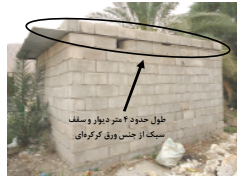
شکل ۱۳- تانکر طول دیوارها، وزن سقف و تیراه پلان در عدم پایداری ساختمانی در روستای کردان
