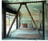
شکل ۶- قاب مهاربندی داخلی فلزی که در همه طبقات دقیقا در یک محل نصب می‌شود
