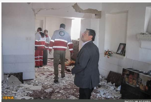
تصویر ۱: نمونه از ترک خوردگی ساختمانها در منطقه زلزله زده
